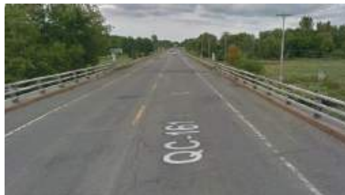
SOURCE : GOOGLE MAPS - PONT DU BOULEVARD D'ARTHABASKA OÙ IL Y A ABSENCE
