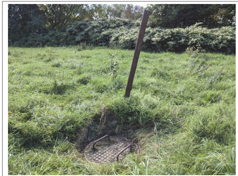
Photo 2 : Vue du puits P-4 Arthabaska (17 septembre 2020)
