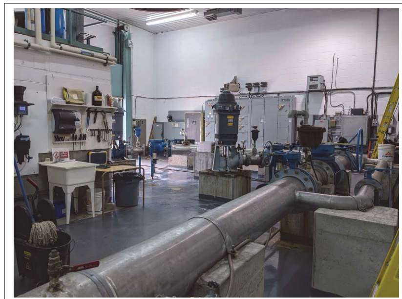
Photo 8 : Vue intérieure de l'usine Arthabaska (17 septembre 2020)
