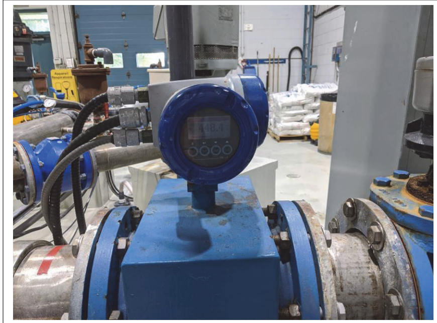
Photo 19 : Vue du débitmètre de l'usine (17 septembre 2020)
