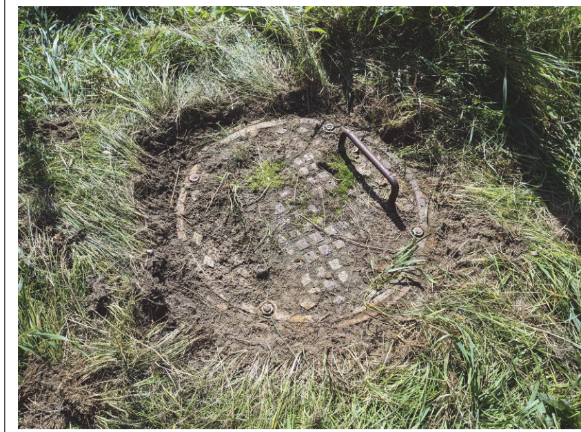
Photo 3 : Vue du puits P-3 Arthabaska (17 septembre 2020)
