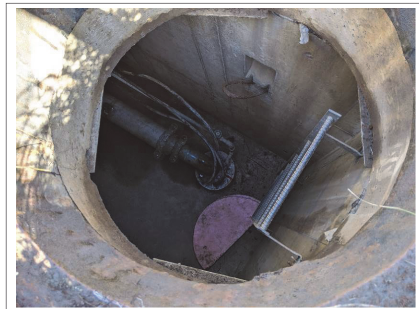
Photo 4 : Vue du puits P-2 Arthabaska (17 septembre 2020)
