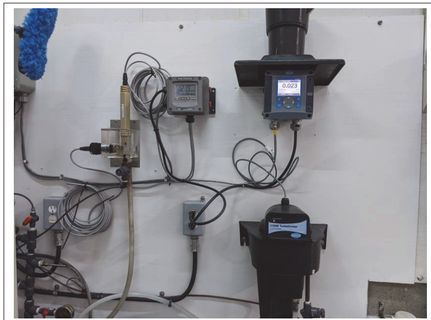
Photo 12 : Vue des analyseurs (17 septembre 2020)
