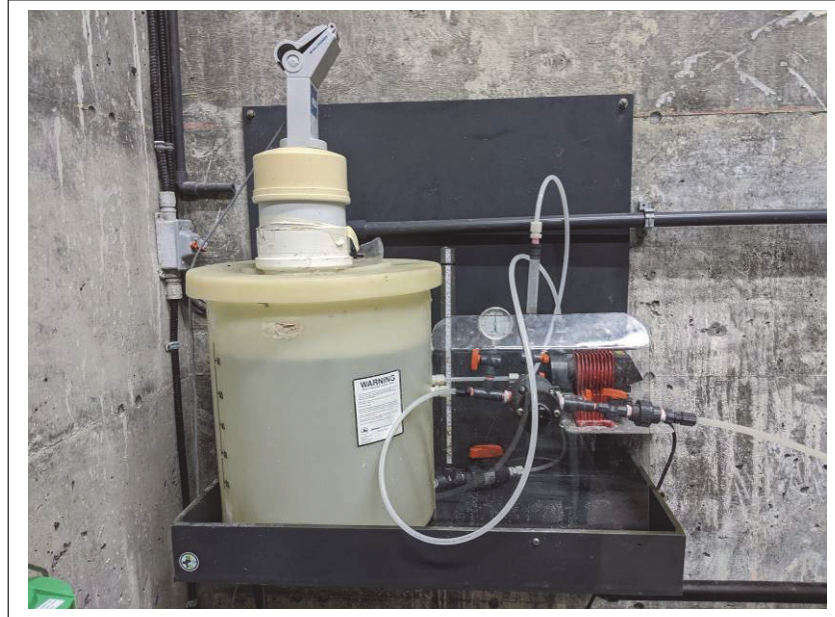
Photo 11 : Vue de la pompe doseuse du chlore (17 septembre 2020)
