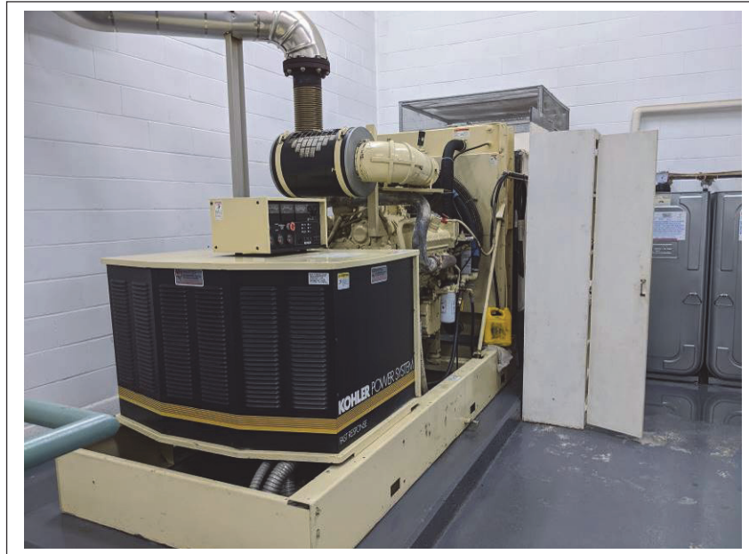
Photo 9 : Vue de la génératrice (17 septembre 2020)
