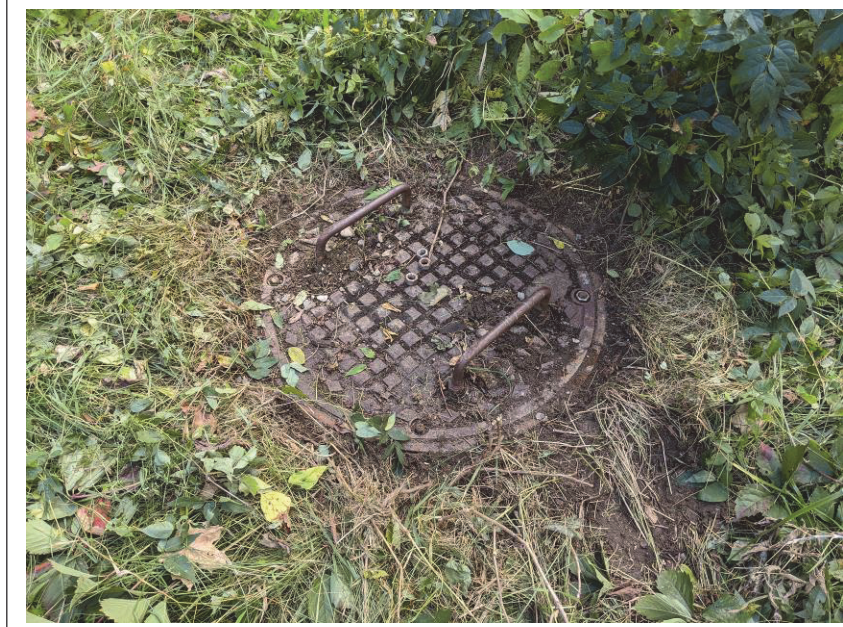
Photo 1 : Vue du puits P-5 Arthabaska (17 septembre 2020)
